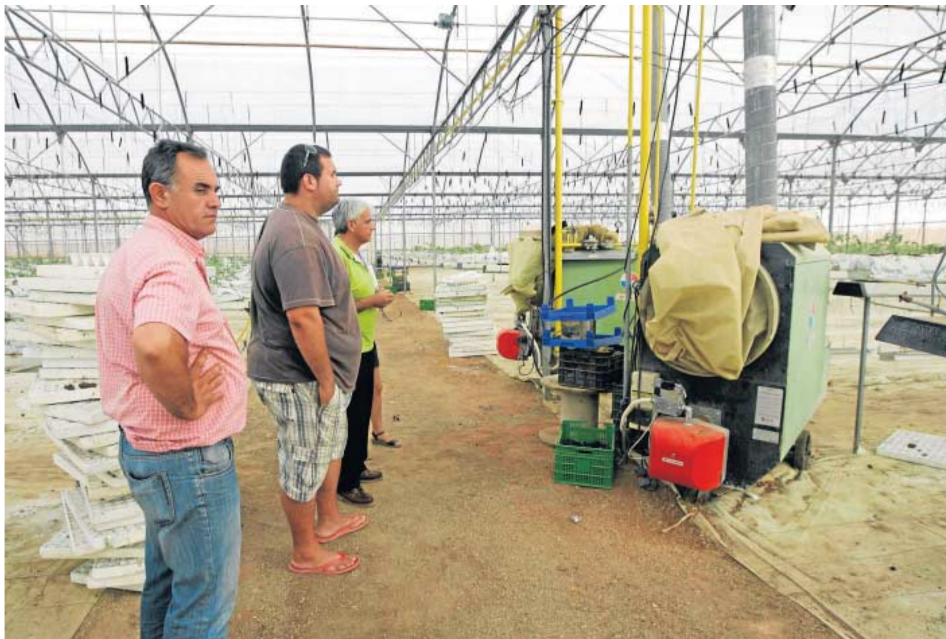
El dueño de la finca, Manuel Berenguel (en primer término), se muestra contento de la transformación de su sistema de calefacción por el ahorro que conlleva.
