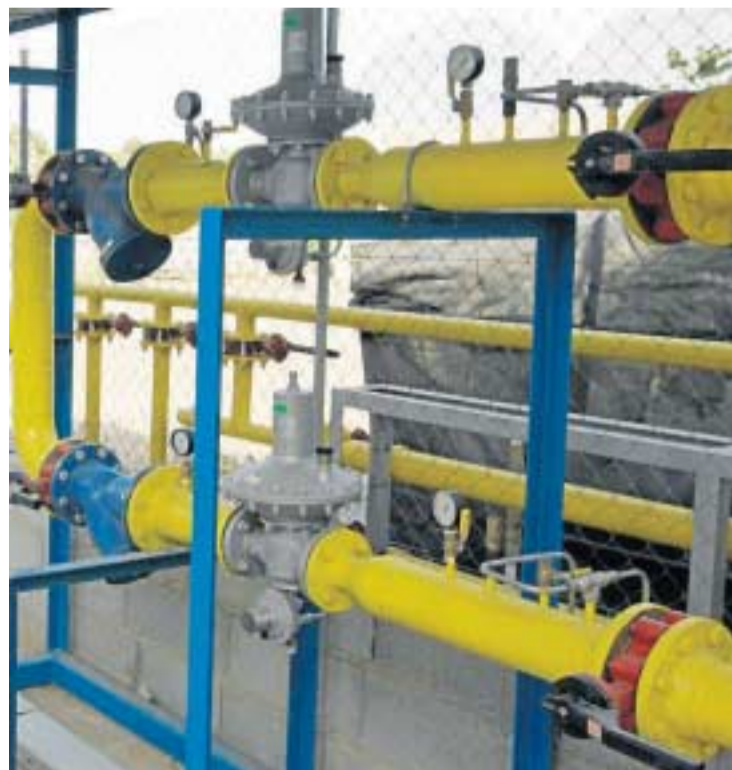
El gas llega al invernadero a través de una red de tuberías.
