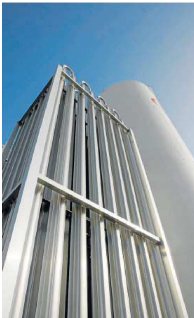
El almacenamiento es totalmente seguro por la volatilidad del gas.
